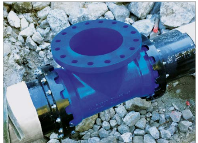
Bild 10: Kontroll- und Reinigungsöffnung, Doppelmuffenstück mit Flanschabzweig (MMA) DN 400/400, Sonderausführung K 15 mit Flanschen PN 63 bar
